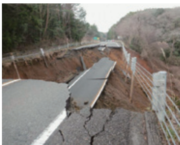
道路の崩壊:石川県HPより
